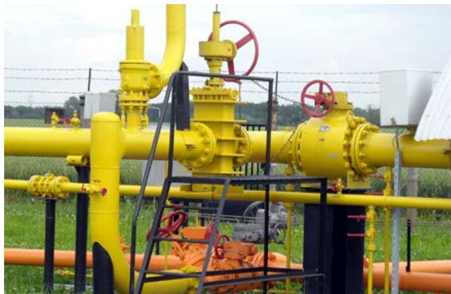
Nyomásszabályozó állomás a Dél-Dunántúlon
